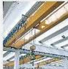
Gru a ponte/carroponte
