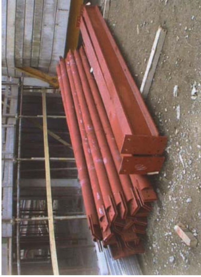
Stoccaggio di travi ed elementi di controventamento preforati in acciaio prima del loro montaggio
