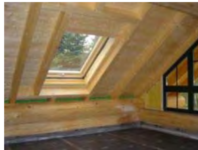
Riscaldamento a Pavimento in Mansarda
